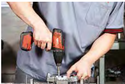
2 Montage der Konsole
