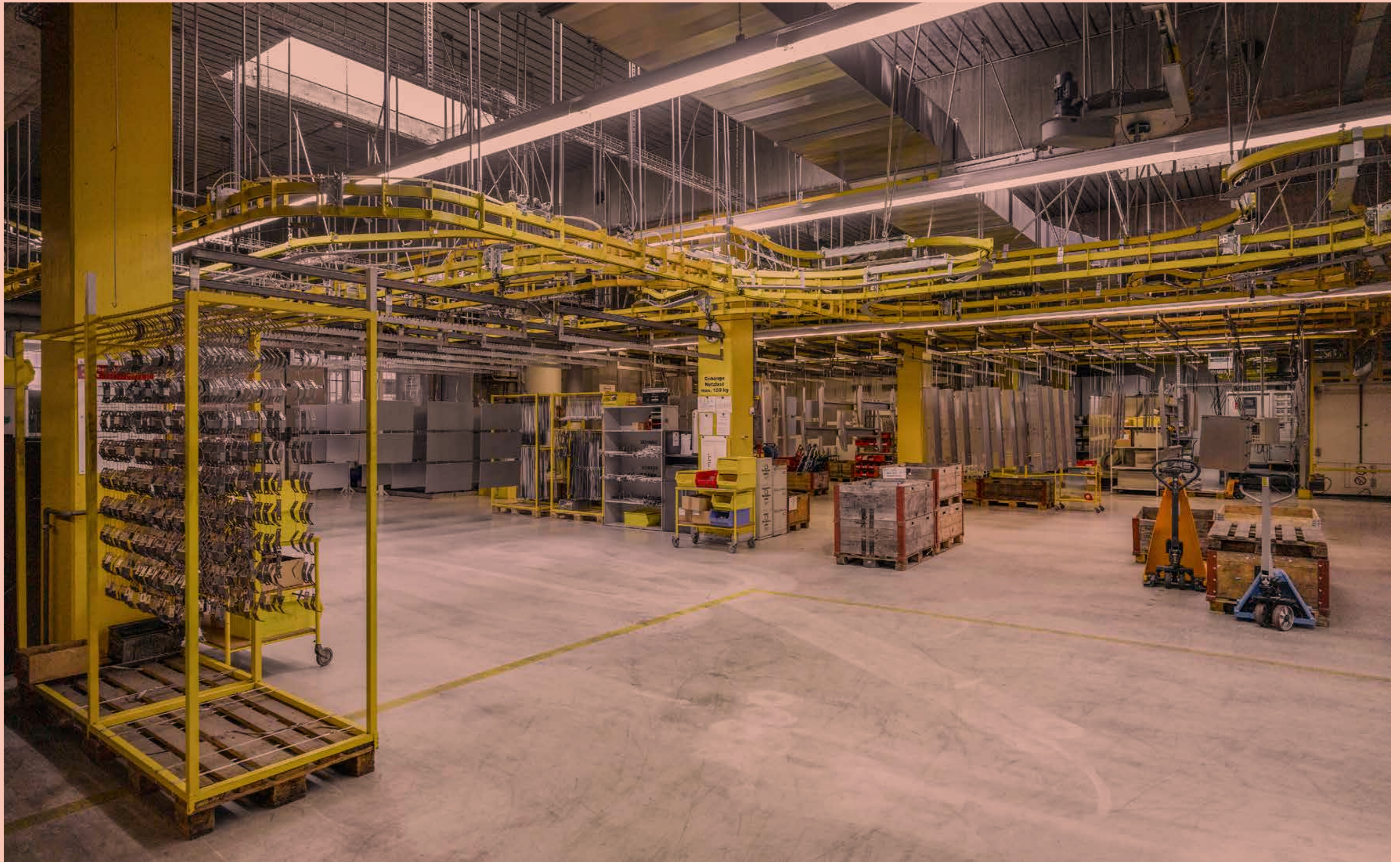
Embru-Werke Pulverbeschichtungsanlage in Rüti (ZH)
